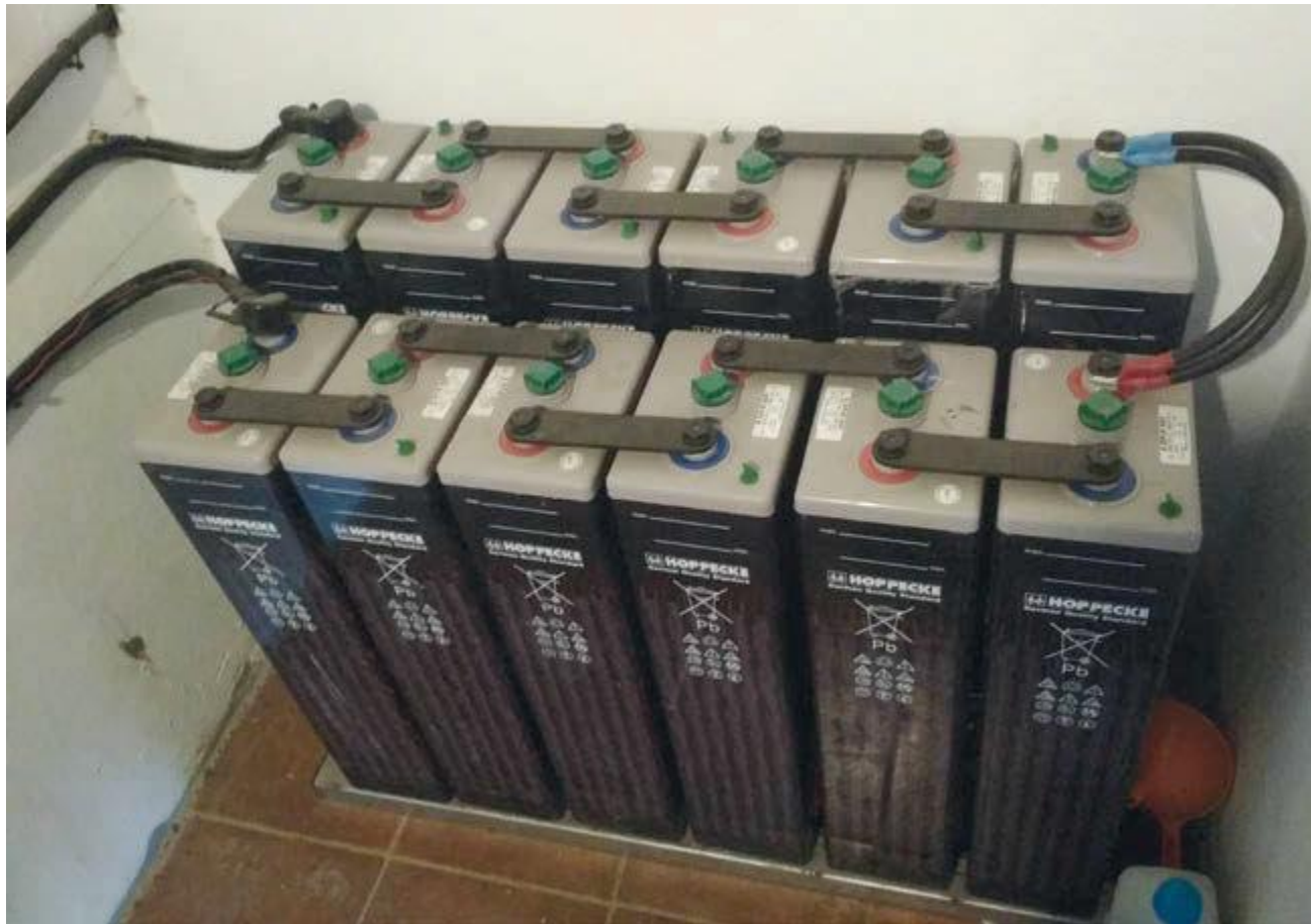
Figura 1.10. Batería solar de 24 V.
