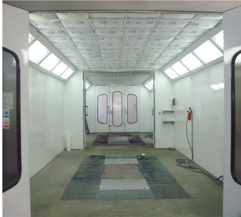
Figura 1.56. Cabinas de pintado.
