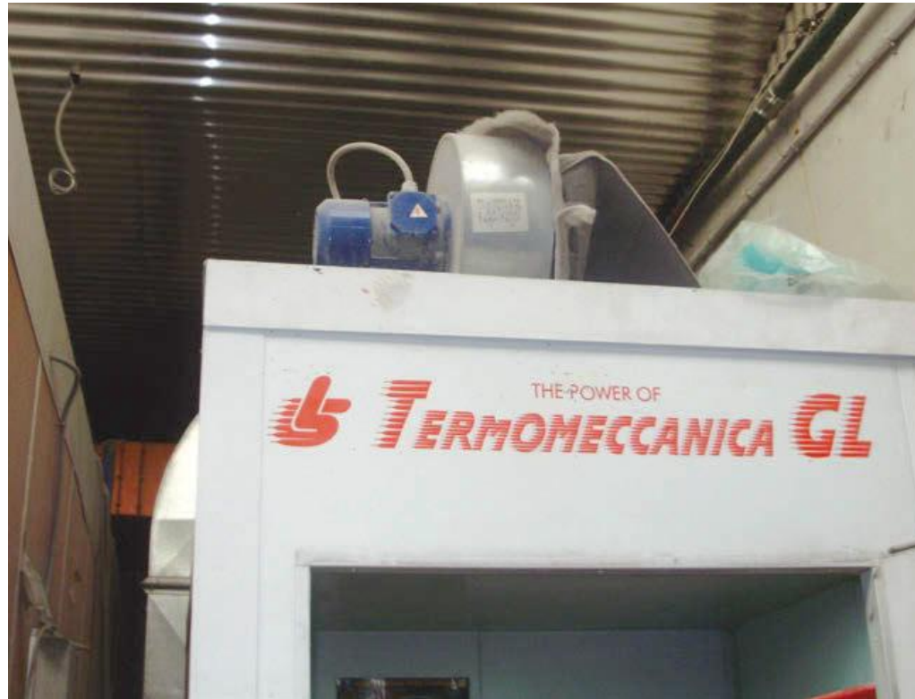
Figura 1.16. Extractor del aire del interior del box .
