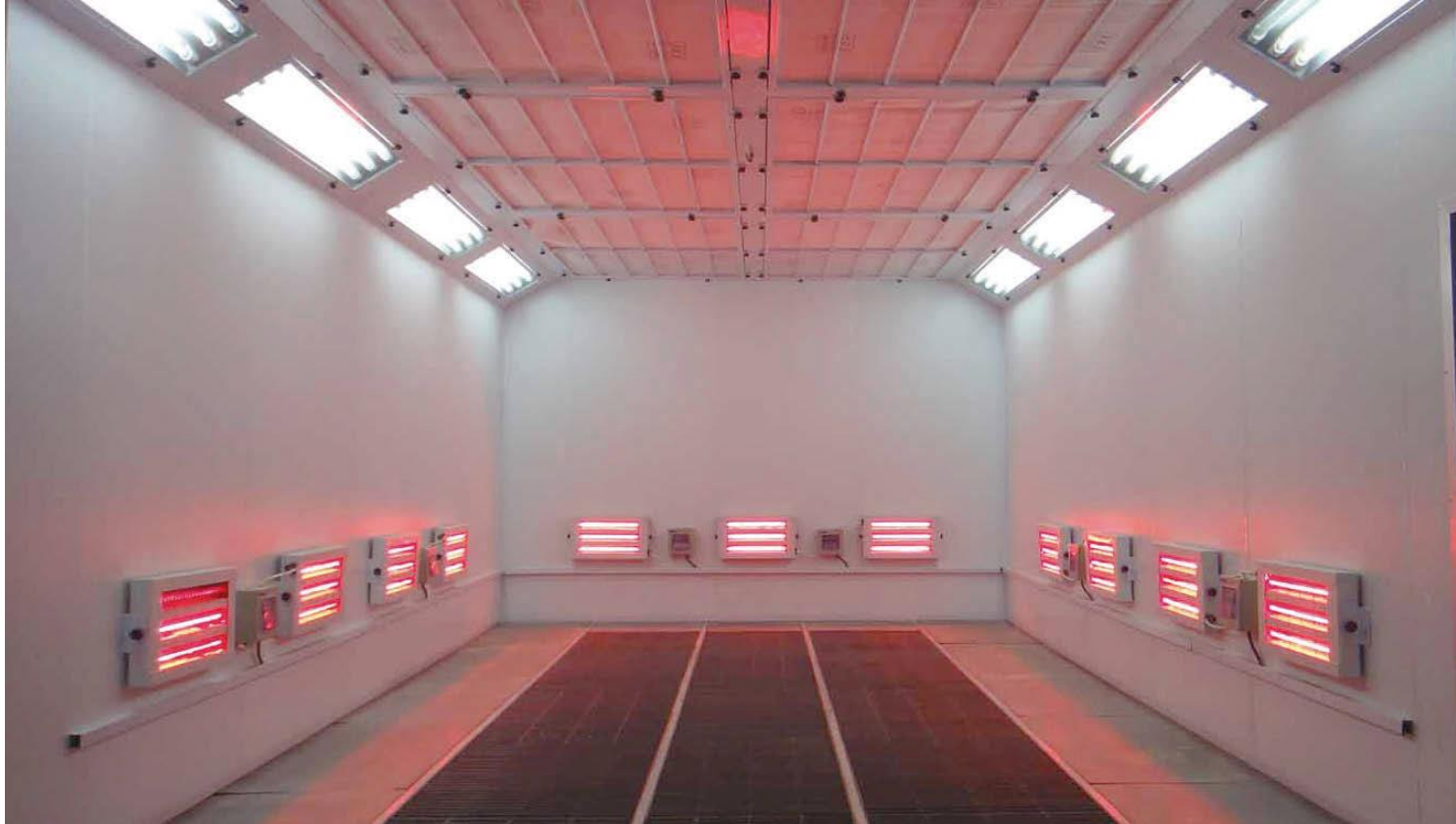
Figura 1.14. Cabina con paneles de infrarrojos.
