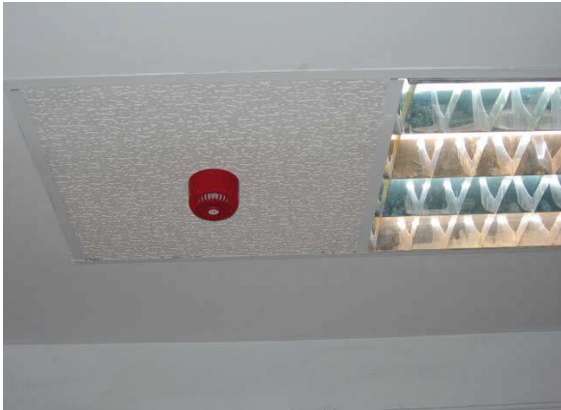
Figura 1.43. Detector de humos del box de pintura.
