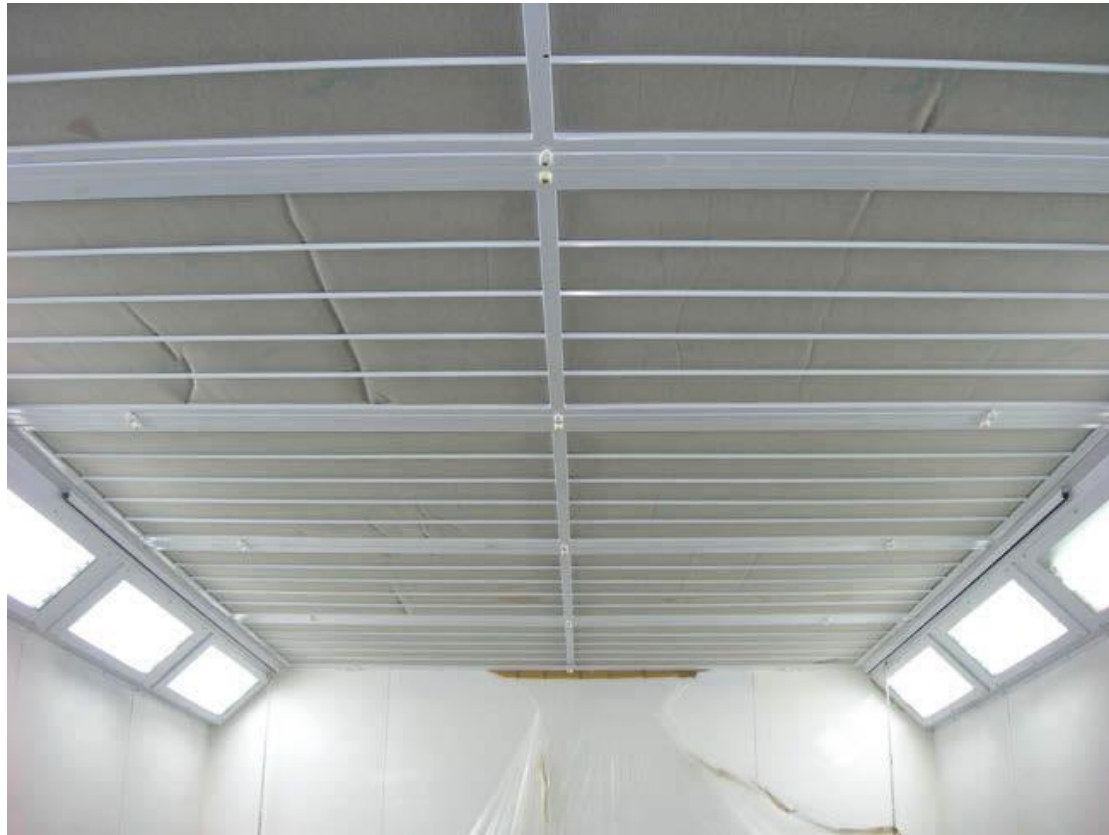
Figura 1.10. Plenum de la cabina de pintura.
