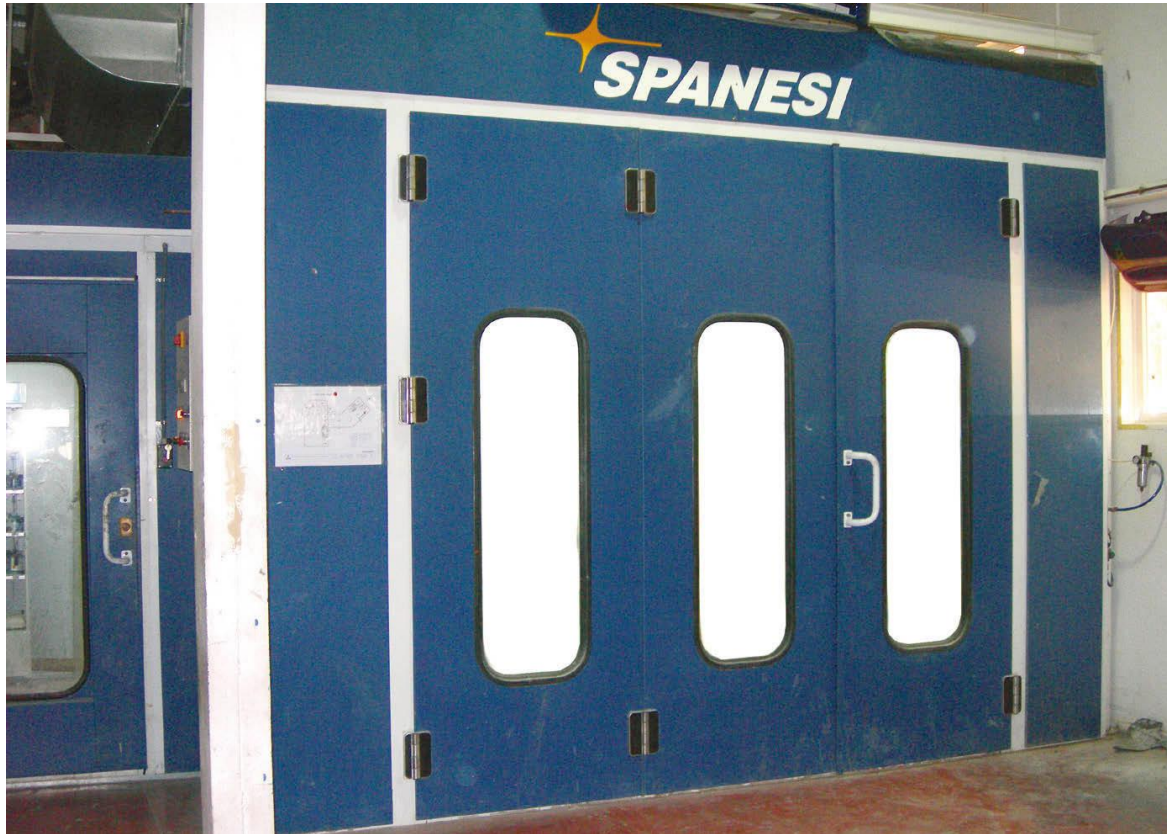
Figura 1.9. Cabina-horno de pintura.
